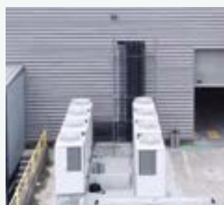
STEMCELL Technologies – глобална биотехнологична компания, инсталира CO 2 кондензаторни агрегати за хладилни помещения в склада. Франция. Охлаждане
